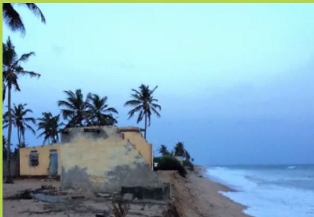
Maison touchée par l'érosion des plages. Photo CSE
